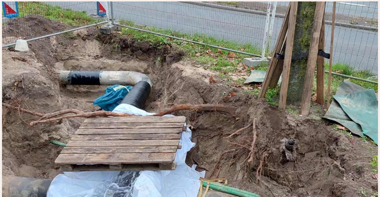
Werkzaamheden aan de Talmalaan. Onwenselijke situatie: veel en ongeordende kabels en leidingen, geen ruimte voor boomwortels, slecht uitgevoerde boombeschermingsmaatregelen (2024)
