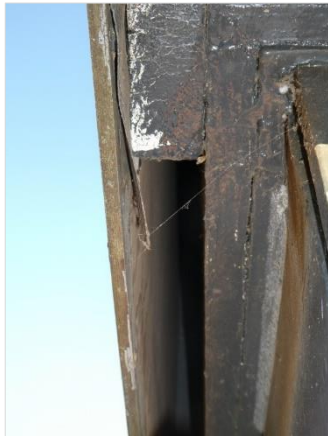
Figuur 4.7 Geschikte opening achter de betimmeringen bij het clubgebouw.
