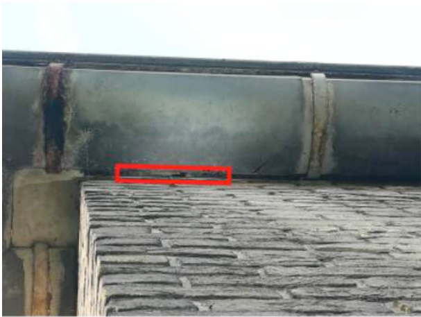
Afbeelding 6: Opening onder de dakgoot, kan toegang geven aan vleermuizen tot de daarachter gelegen ruimtes. Foto: M. Oomen, Ecoresult B.V.
