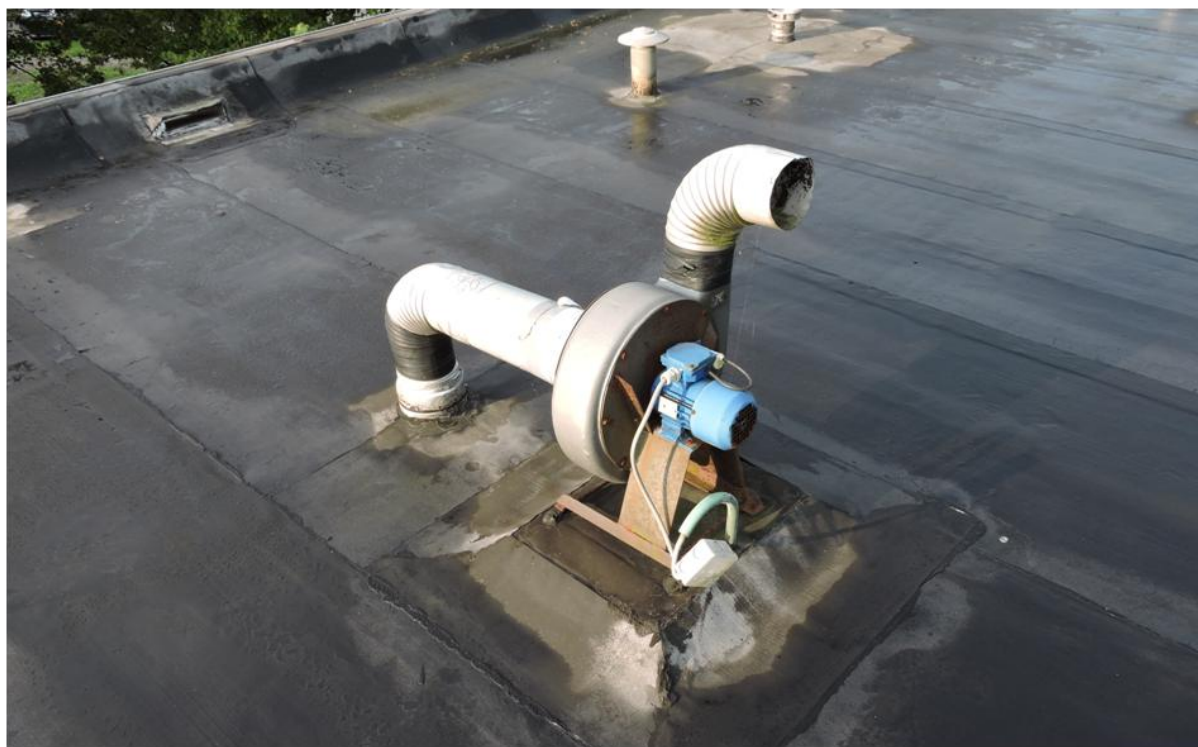
Foto C10 | verouderde en verweerde dakventilator
