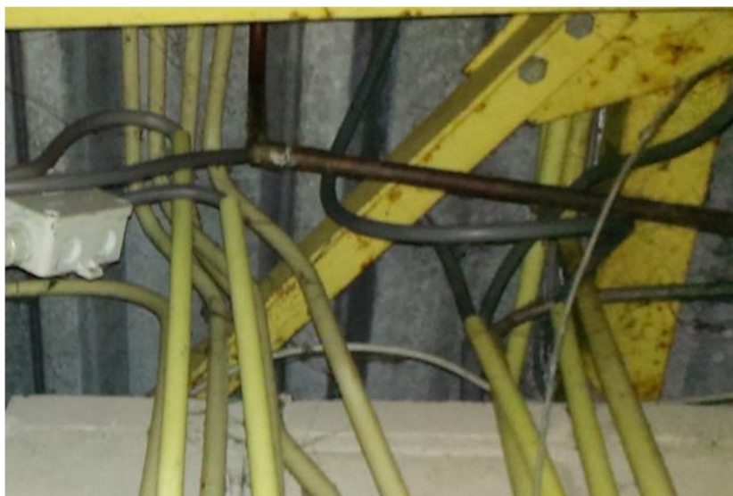
Foto C5 | corrosie op staalconstructiedelen laagbouw
