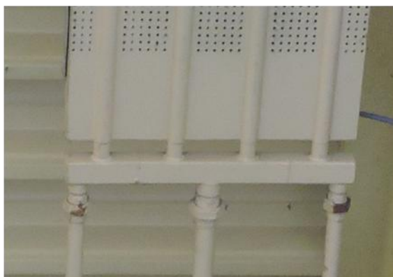
Foto C6 | corrosie op koppelstukken stralingsplafonds
