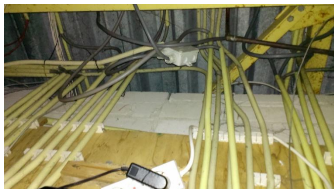
Figuur 5 | afbeelding van elektrotechnische infrastructuur
