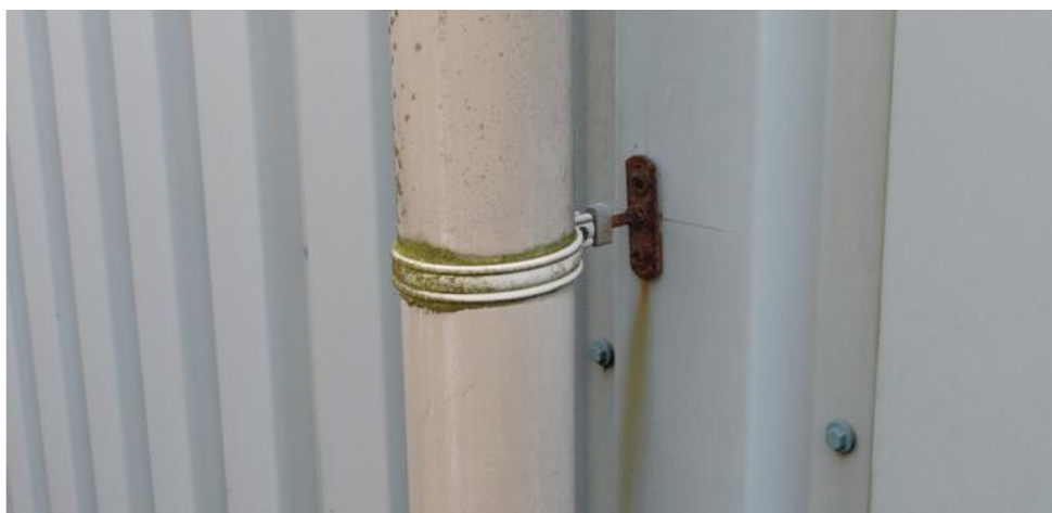
Foto C3 | Sterk gecorrodeerde bevestigingsmiddelen HWA's
