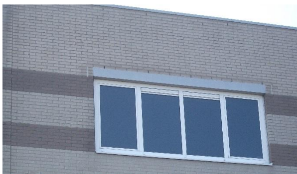
Figuur 15. Open stootvoegen in een gebouw ten zuiden van de A12.
