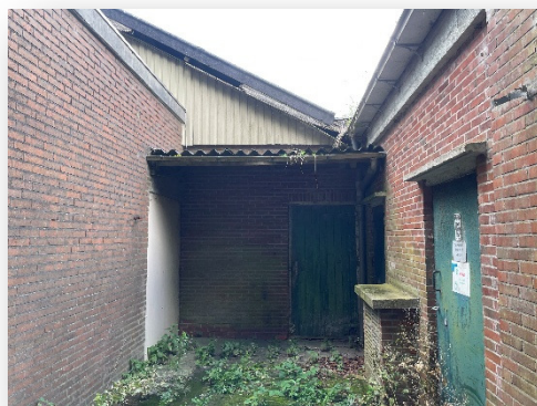
Afdak van asbesthoudende golfplaten nabij traforuimte
