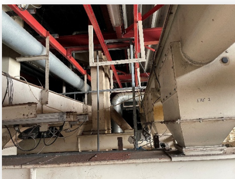
Installaties in silo – doseer ruimte niet verdacht
