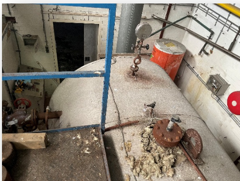
Ketel niet verdacht
