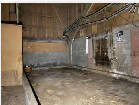
Isolatiemateriaal niet verdacht
