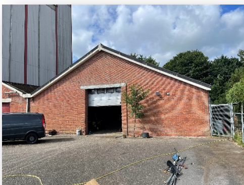
Opslagruimte met asbesthoudend golfplaten dak, wordt gebruikt als paardenstal
