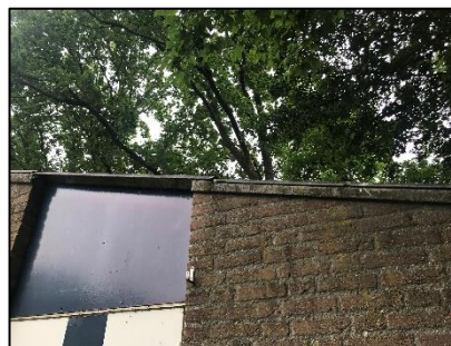
Foto's 19. Opening tussen daktrim en muur van het gebouw
