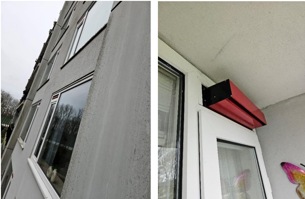
figuur 5: ventilatieroosters (links = woonkamer, rechts is slaapkamer)
