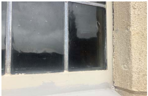
46.1 schilderwerk in deels afwijkende kleur
