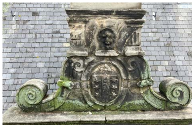
35.6 scheuren en ontbrekend voegwerk dakkapellen
