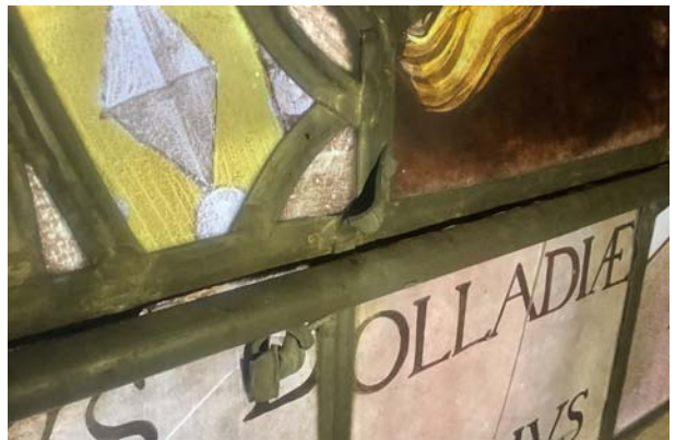
34.2 Gebroken en weggevallen bindroosjes
