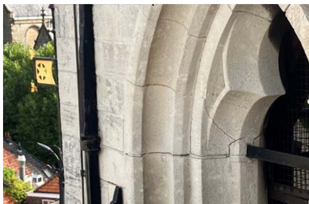
25.1 door roestende ankers opgedrukte constructie
