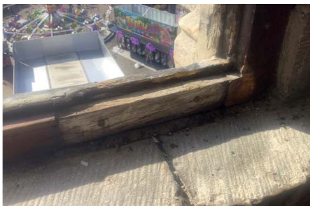
30.4 schade agv structureel gebruik vlaggenmasten
