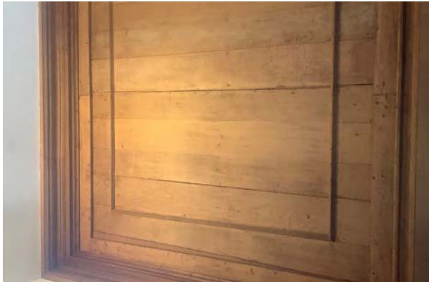
45.4 openstaande naden plafonds
