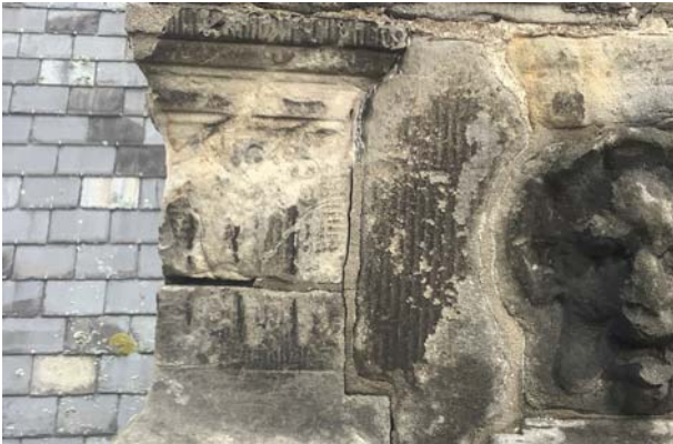
22.1 voegwerk natuursteen dakkapellen weggevalen
