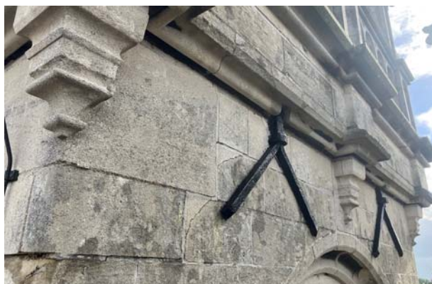
25.1 door roestende ankers opgedrukte constructie
