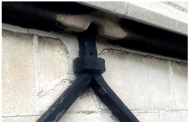
25.1 door roestende ankers opgedrukte constructie
