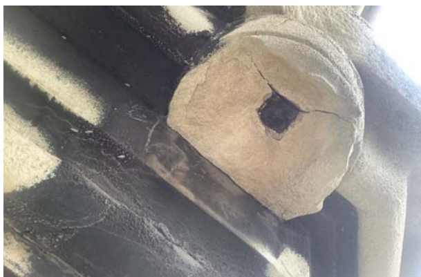
35.5 gescheurde- en reeds weggevallen
