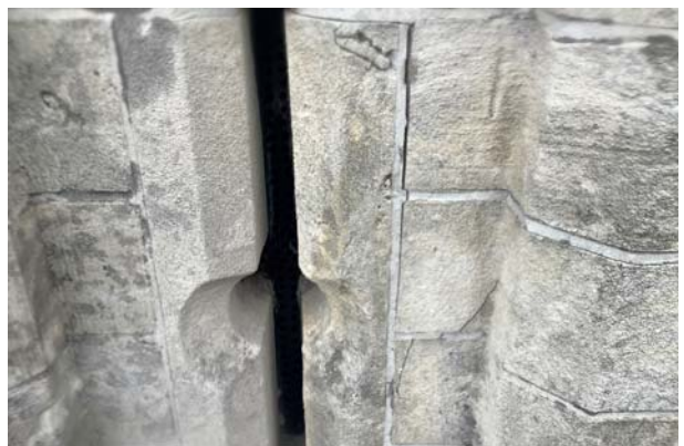
35.2 scheurvorming hoektoren zuid
