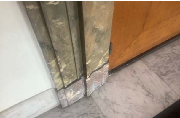
46.7 plaatselijk sterk verkleurd imitatiewerk
