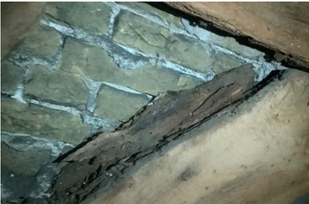
24.3 aangetaste onderdelen eerste spant vanaf west
