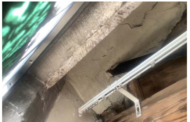
46.8 afgebladderd schilderwerk op pleisterwerk
