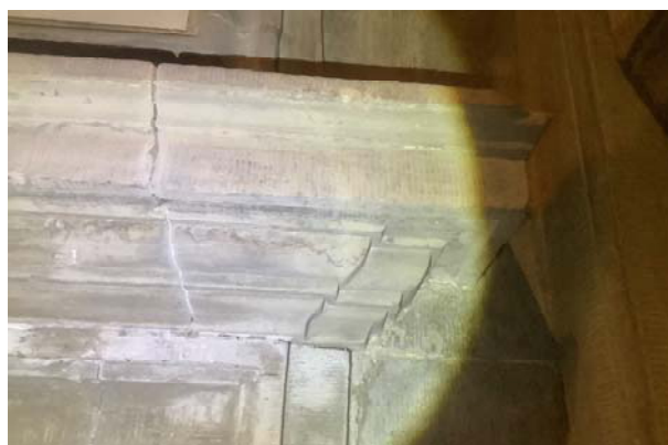
35.8 scheuren in natuursteen delen benedenplein
