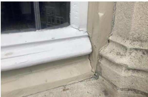
46.1 scheuren op liggende delen en verbindingen
