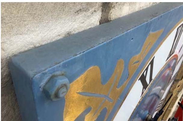
46.2 roestvorming verfwerk wijzerplaat zuidzijde
