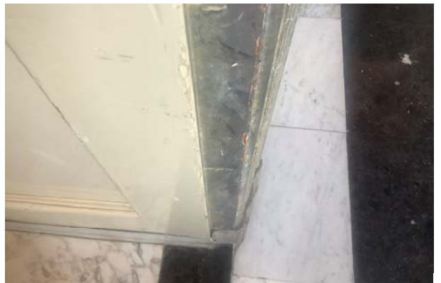
46.6 plaatselijk zwaar beschadigd binnenschilderwerk
