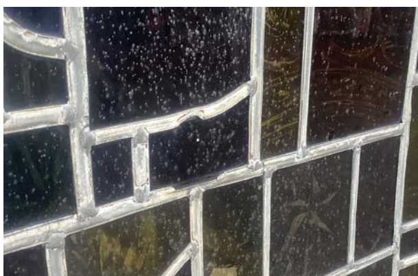
34.1 Devitrificatie gebrandschilderd glas noordgevel
