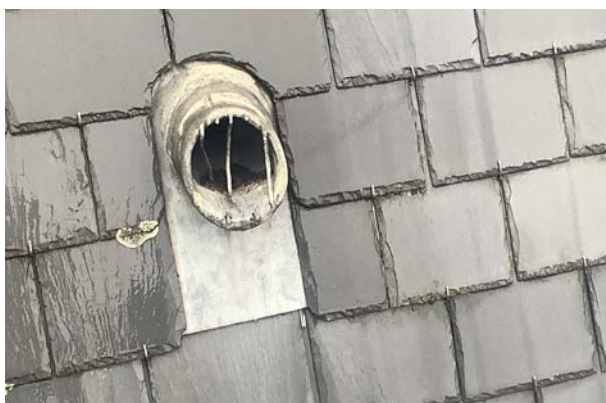
33.2 beschadigde loden dakdoorvoer
