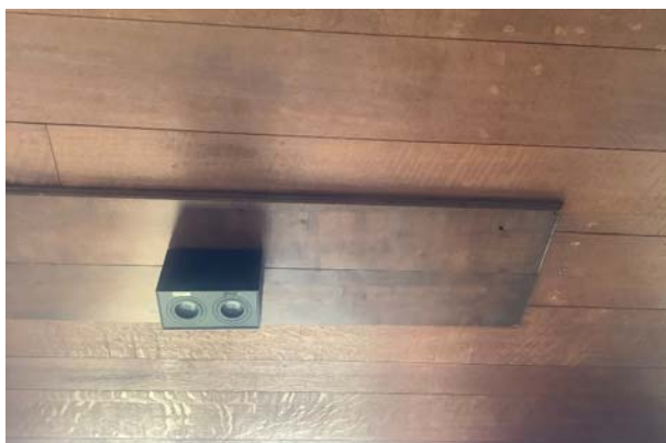
45.4 ondeugdelijke herstelling rondom armaturen
