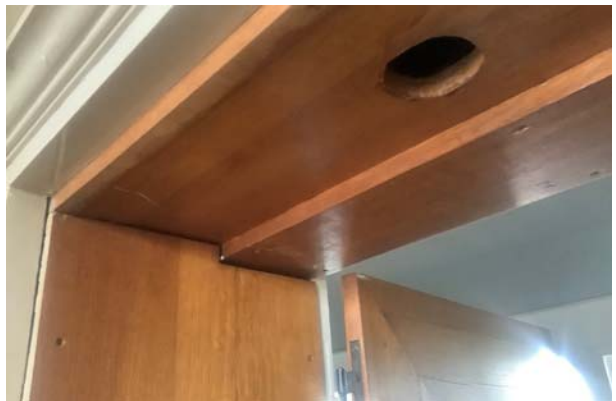
45.7 betimmering met oude gaten
