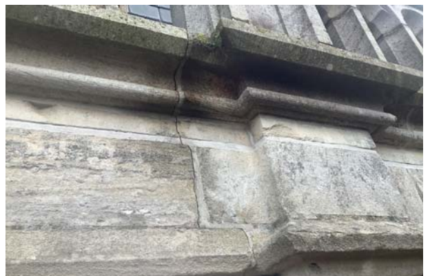
35.5 vertical scheur onder balustrade middentoren
