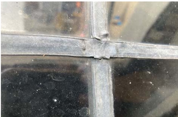
34.2 gebroken loodflenzen verspreid
