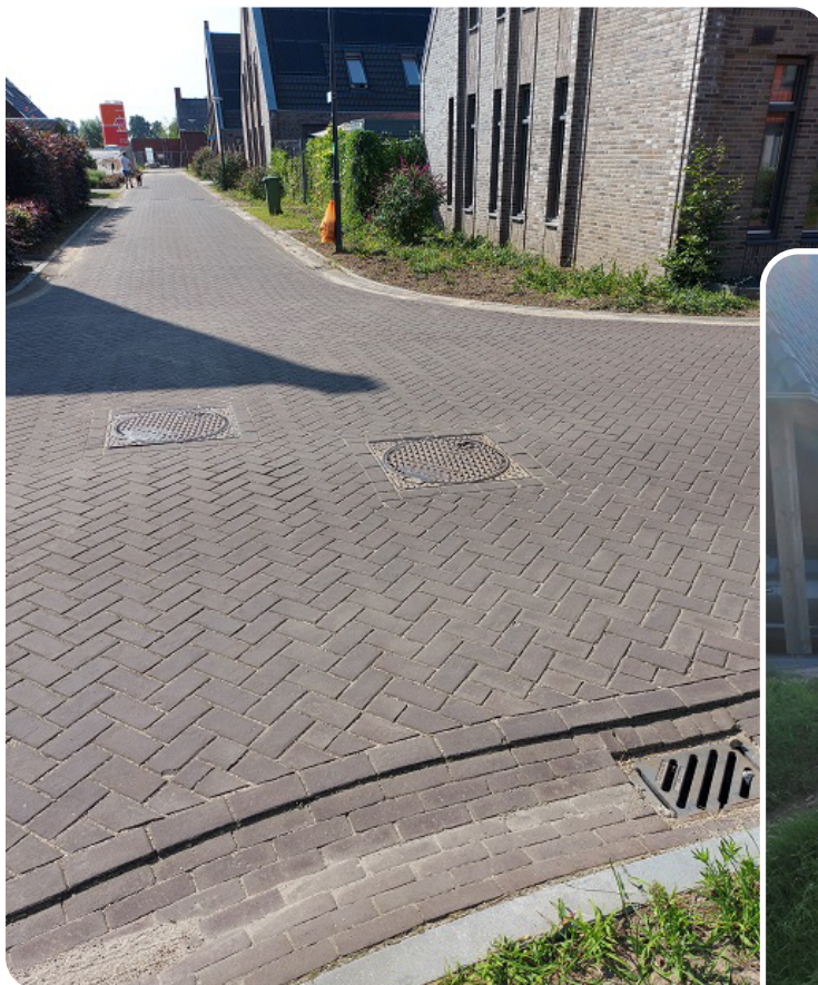
Afbeelding 37: Inspectieputten in de weg
