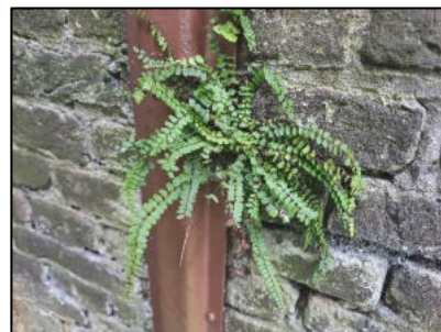
Figuur 5.3. Steenbreekvaren onder brandtrap op noordelijke luchtplaats.
