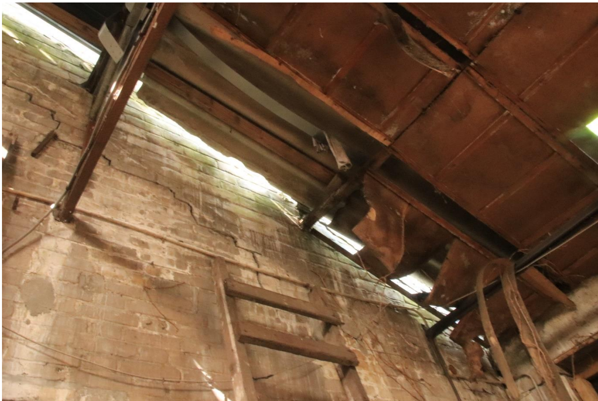
Foto 3: Meerdere openingen in de constructie van de opslagloods maken dat er een instabiel klimaat heerst en daarmee vormt deze plek geen geschikte vaste rust- en verblijfplaats voor vleermuizen
