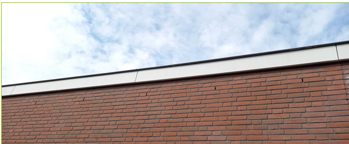
Figuur 3 Open stootvoegen en een kierde daklijst bieden vleermuizen de mogelijkheid achterliggende holle ruimten te bereiken
