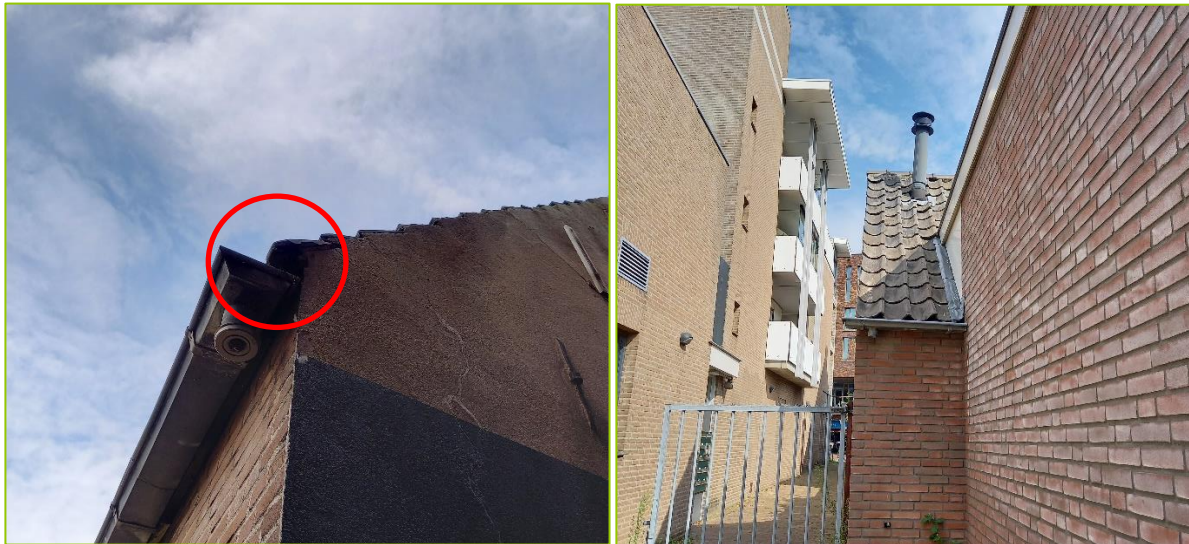
Figuur 4 Binnen het plangebied zijn meerdere potentiële nestlocaties van huismus gevonden, met name onder de dakpannen
