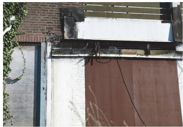
Fig. 10. Sporen van brand. Er zijn met de brand geen geschikte ingangen voor b.v. vleermuizen ontstaan door de brand.
