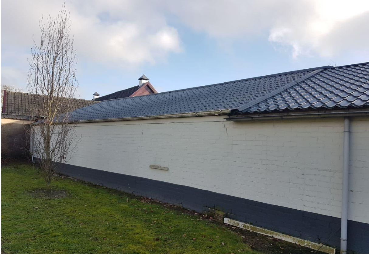
Figuur 6. Aijde bedrijfsplandmet metalen dakplaten als dak en lat tussen dak en muur.
