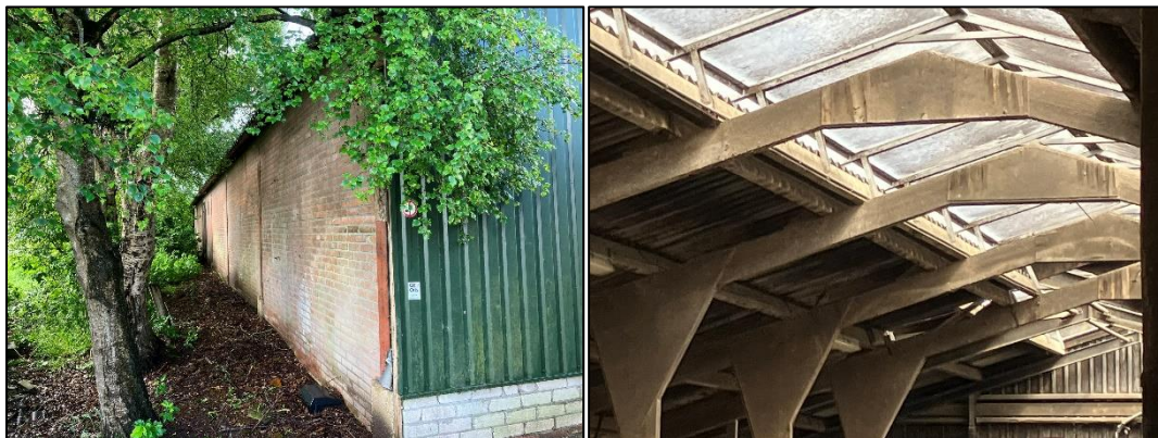
Figuur 2.15 (links): De oostzijde van de opslag; Figuur 2.16 (rechts): Een blik op het dak van de opslag, gezien vanuit de binnenkant.
