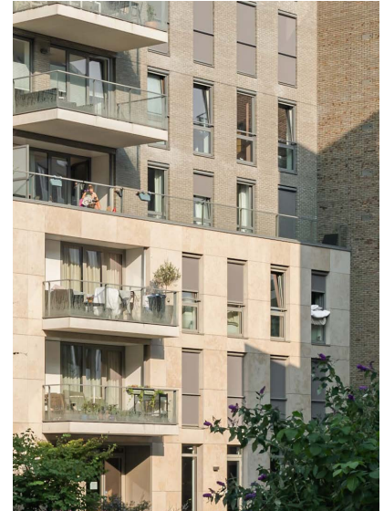
Verkleuring tussen onderste bouwdeel en deel erboven. Cruquiuseiland, A'dam (KCAP)
