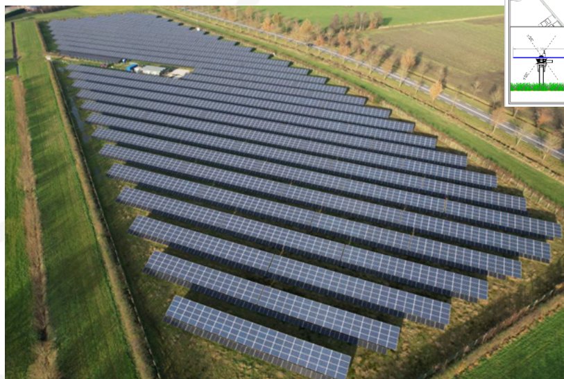
Energiepark Heeten (2,1 GWh)
