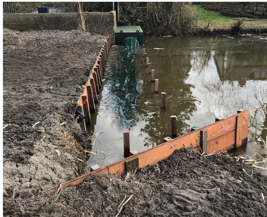
Dit is een voorbeeld van een vuilfuik in een watergang. Na een overstort wordt vuil uit de riolering opgevangen in een soort net zodat het grove vuil niet in het oppervlaktewater komt.
