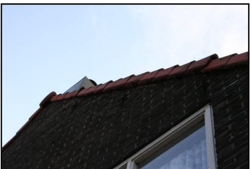
Foto 5: Speten en kieren onder dakpannen en nokvorsten
