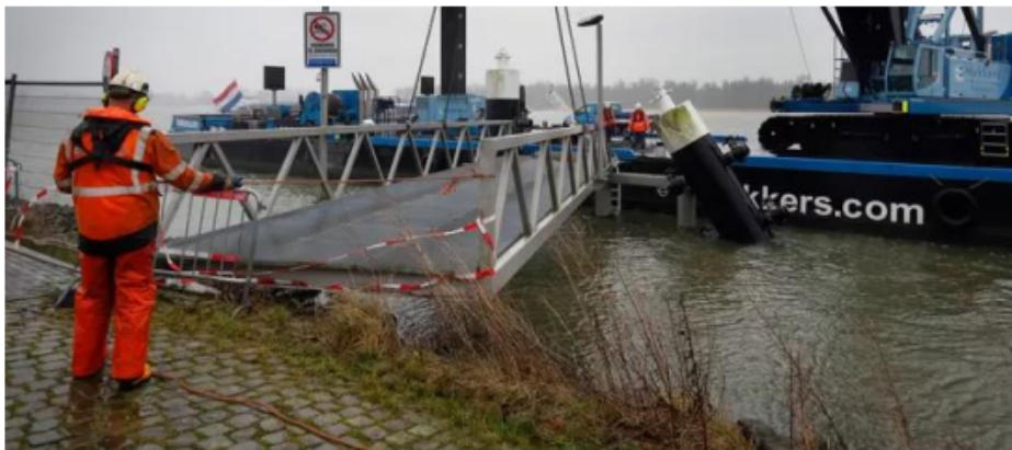
▲ De firma Hakkers takelt de beschadigde aanlegsteiger Buiten de Waterpoort weg. © Cor de Kock
