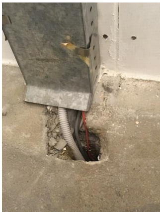
Afbeelding 2 Archiefruimte 2; beschadiging vloer
