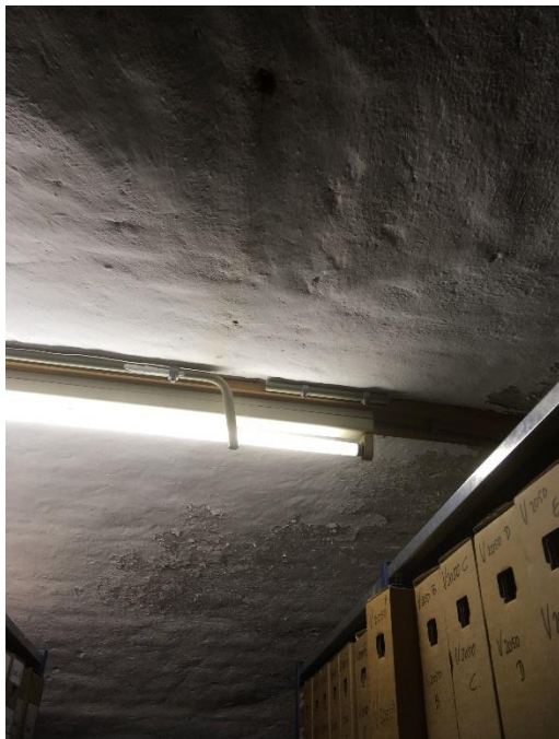
Afbeelding 5 Archieftruimte kelder; loslatend pleisterwerk plafond
