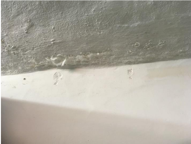
Afbeelding 4 Archieftruimte kelder; schimmel plafond
