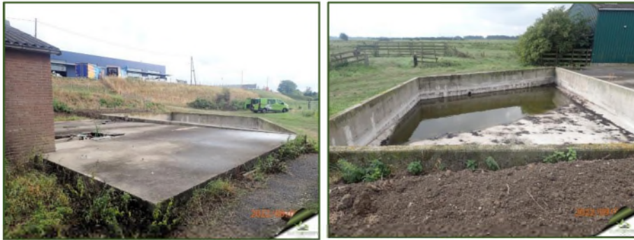
Figuur 8. Mestkelder afdekking en mestopslag
