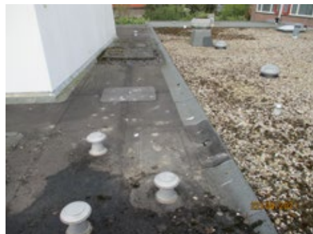
Slechte staat dakbedekking
