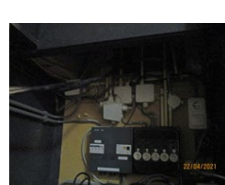
Één van de 5 verouderde meterkasten
