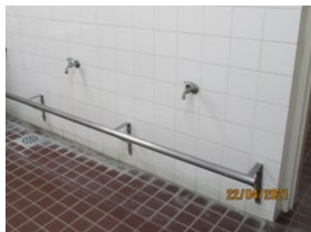
Verouderde tegelvloer kleedruimtes
