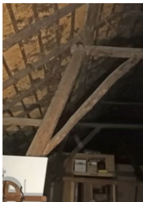
Ongeïsoleerde en brandgevaarlijke rieten kap
