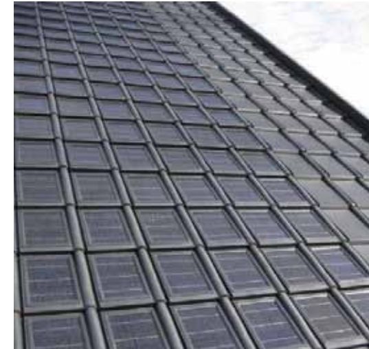
zonnepanelen in dakvlak
