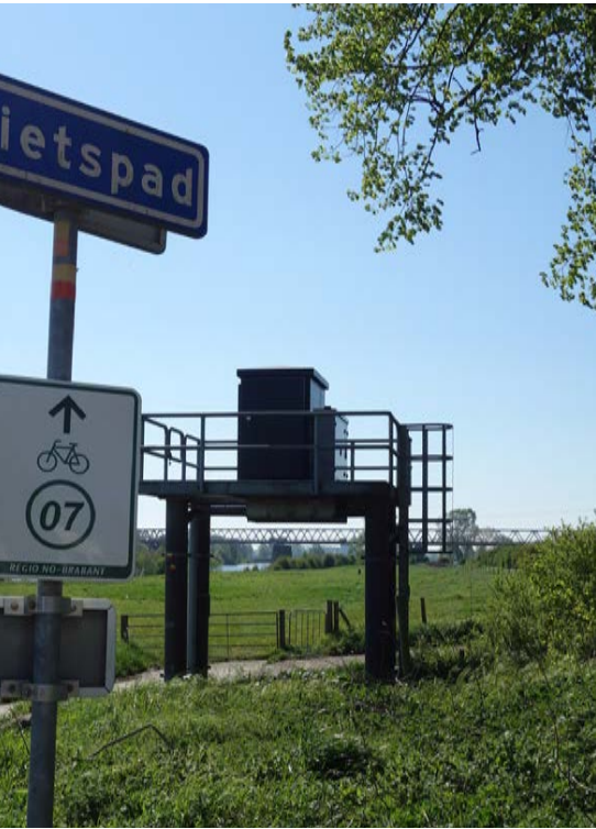
de verhoogde electriciteitskasten geven de hoogte aan van het over- stromingsgebied van de Maas
