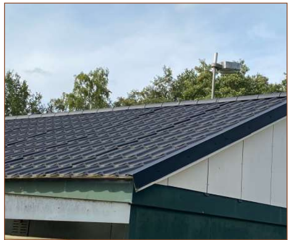
Afbeelding 2.2 – De kunststof dakpanelen bieden geen vaste verblijfplaatsen voor Huismus door grote temperatuurswisselingen. Het wordt er te heet in de zomer en biedt geen bescherming tegen de koude in de winter.
