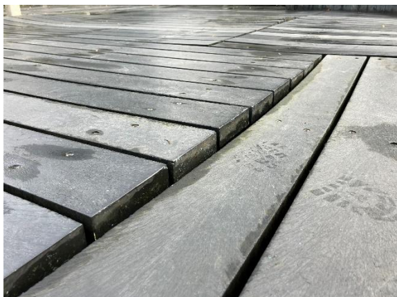
KUNSTWERK (032 Koningskamp / Lagelaan Steiger in vijver) Schade: Deformatie kunststof dekbeplanking. Oorzaak: Ontwerpfout. Risico: Verminderd comfort gebruikers en struikelgevaar. Maatregel: Aandachtspunt komende instandhoudingsinspectie.
