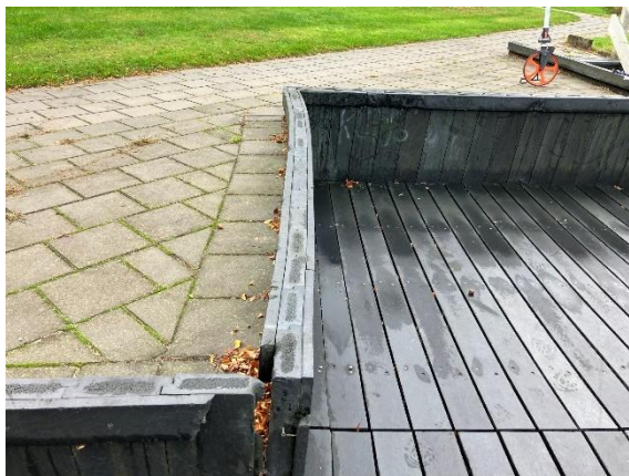
KUNSTWERK (032 Koningskamp / Lagelaan Steiger in vijver) Schade: Deformatie kunststof damwand. Oorzaak: Overbelasting. Risico: Bezijken constructie. Maatregel: Aandachtspunt komende instandhoudingsinspectie.
