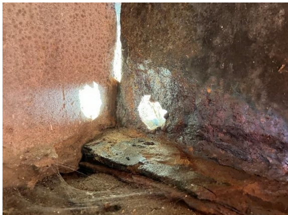
KUNSTWERK (003 Betonbrug Dwingelderdijk te Dwingelo over de Dwingelerstroom) Schade: Gaten in hoofddraagconstructie. Oorzaak: Vergevoerde corrosie. Risico: Bezijken hoofddraagconstructie Maatregel: Technische inspectie en constructieve herberekening (zie paragraaf 3.4 'Nader onderzoek')
