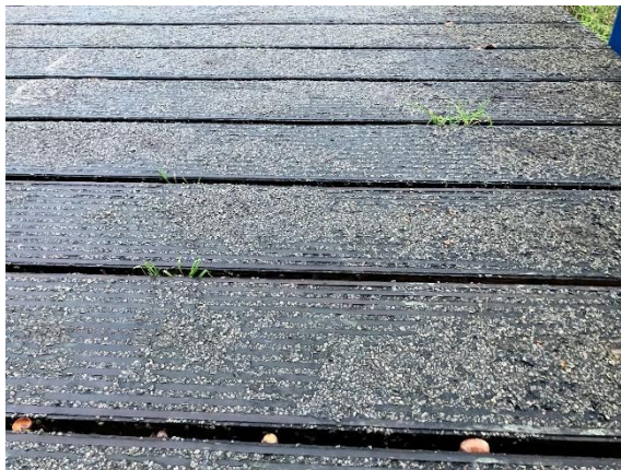
KUNSTWERK (015, 022, 030) Schade: Slijtlaag onthecht. Oorzaak: Verkeersbelasting. Risico: Verminderde stroefheid rijdek, met uitglijdgevaar tot gevolg. Maatregel: Vervangen slijtlaag.
