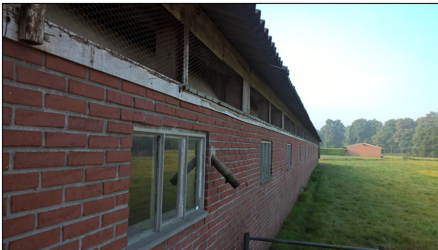
Foto 4.3: Met gaas dichtgemaakte ventilatieopeningen in één van de schuren in het plangebied.
