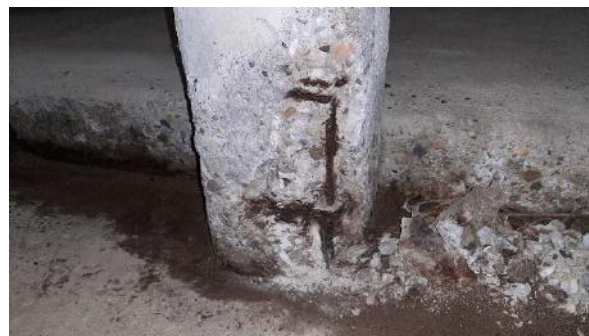
02] Aanzicht schade kolom
