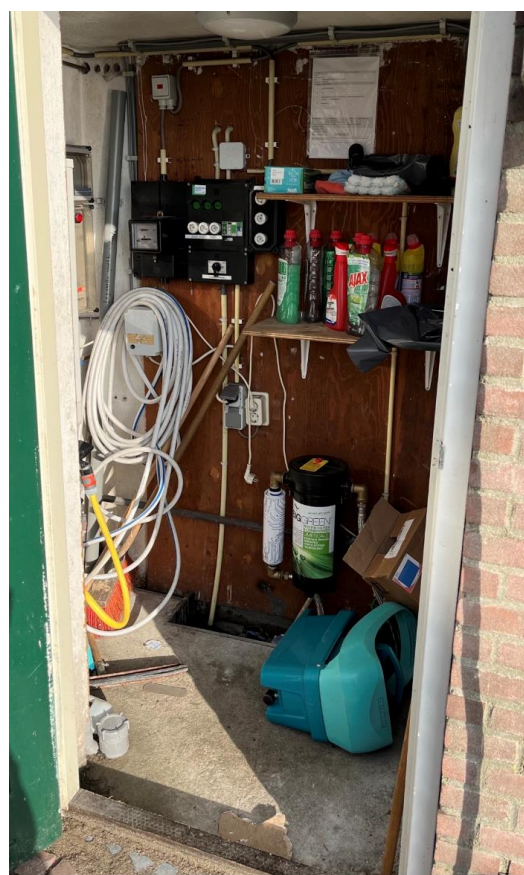
Foto meterkast drinkwater – vóór
