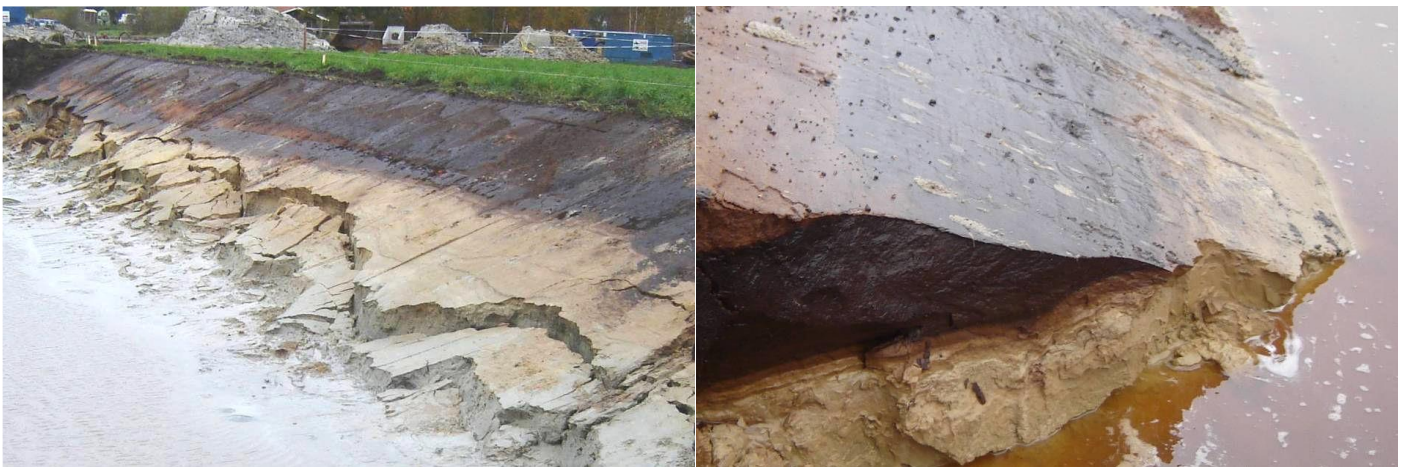
Figuur 2 Foto's van een kwelsloot in polder Giethoorn, waarbij door de waterdruk onder de oerlaag het talud is ingestort [4].
