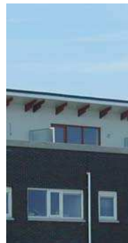
Terugliggende bovenste laag, aandacht dakranden.
