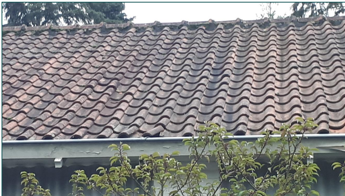
Figuur 3.2 In de bebouwing zijn er meerdere scheefliggende dakpannen aanwezig.
