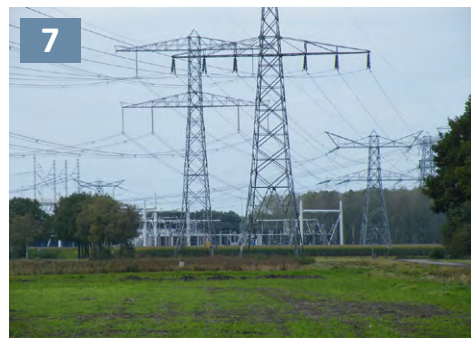
Afbeelding 19. Zicht op hoogspanningsstation Meeden.
