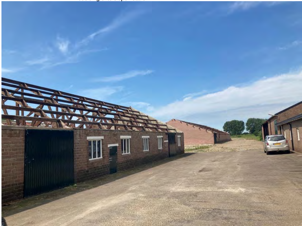
• Afbeelding 3: te slopen stallen
