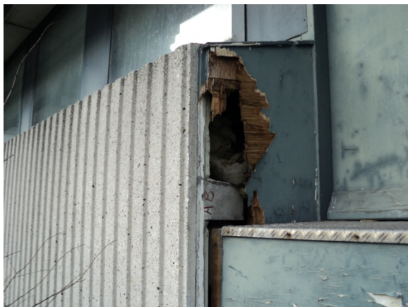
Beschadiging (na asbestonderzoek) van de buitenmuur aan de oostgevel op 1,5 meter hoogte.
