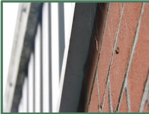
Afbeelding 28: Geen ruimte tussen de wanden en damwand
