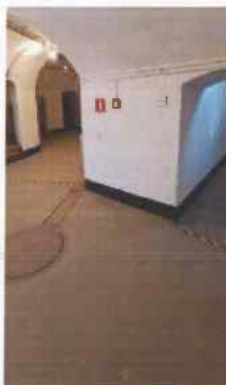
Geen brandblusser aanwezig ondanks aanduiding
