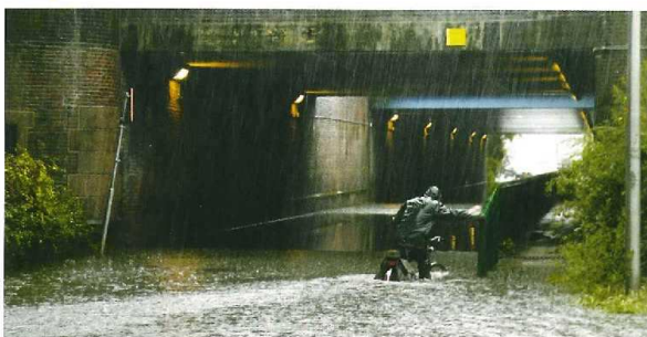
4.3 Schade: ondergelopen gebouw
