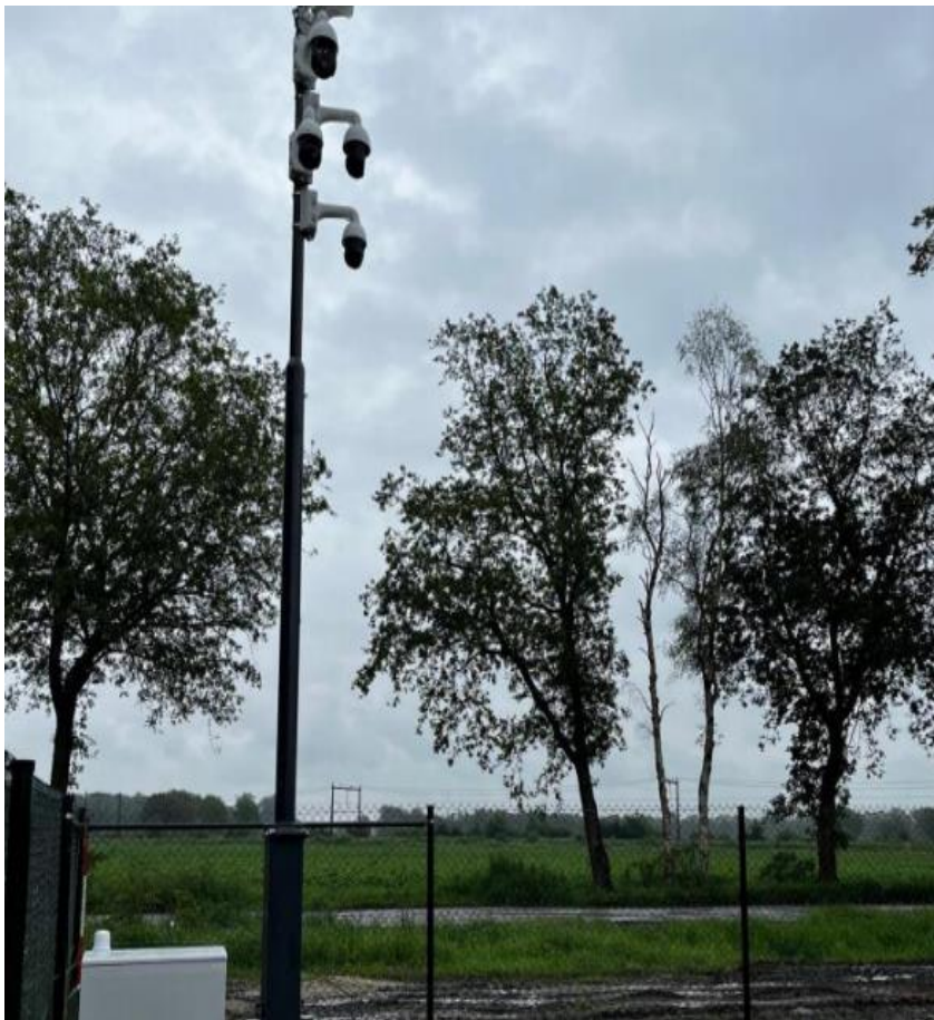
Figuur 6 Voorbeeld van een cameramast op een zonnepark
