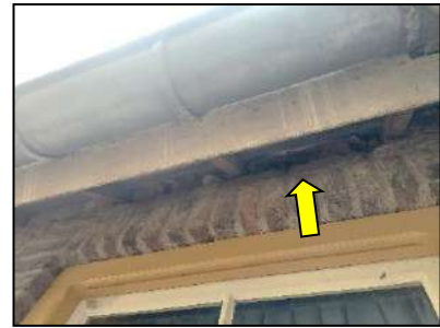
Figuur 23. Losgetrokken isolatiemateriaal.
