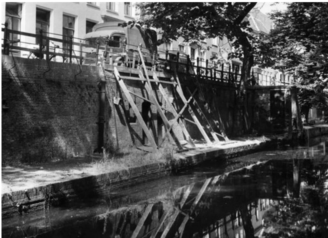
Figuur 17 – begin 20e eeuw trad verval in van de werven en werfmuren zoals aan deze gestutte muur is te zien. De gemeente wou ingrijpen en heeft vanaf 1948 actief werven en muren verworven.
