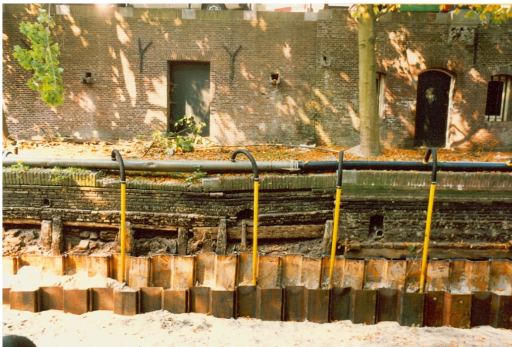
Figuur 28 – aanzicht oude gemetselde walmuur die deels is bezweken. De walmuur is op een houten fundering gebouwd. In de muur zijn gemetselde rioolafvoeren te zien.
