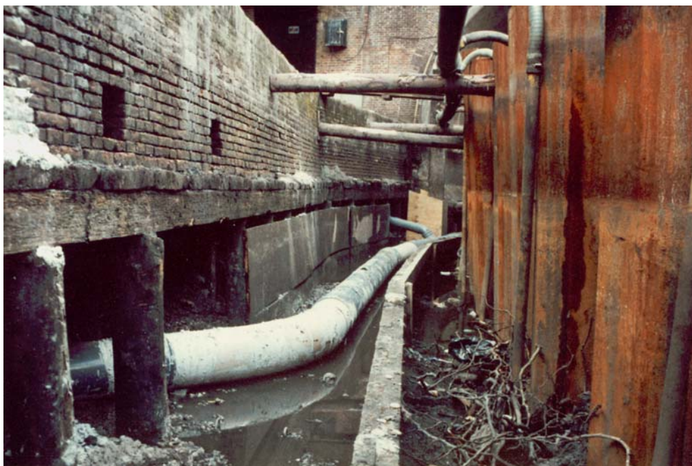
Grachtriol met doorvoer naar inspectieput.
