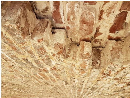
Figuur 50 – tijdens het inboeten van metselwerk onder de brug Paushuize bleek dat de onderste metselwerkschil (halfsteens) niet in verband was gemetseld met de rest van de boog, en dus een façade bleek.
