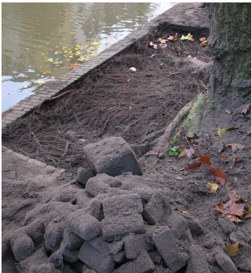
Boomwortels groeien tot aan de walmuur
