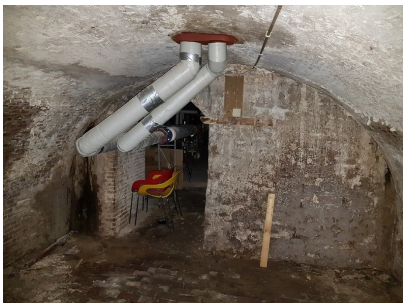
Figuur 58 – in kelder Kromme Nieuwegracht 66 is in de werfkelder een sparing gemaakt voor de doorvoer van stadsverwarming. In de aansluitende woonkelder is een heel systeem van de stadsverwarming aanwezig.
