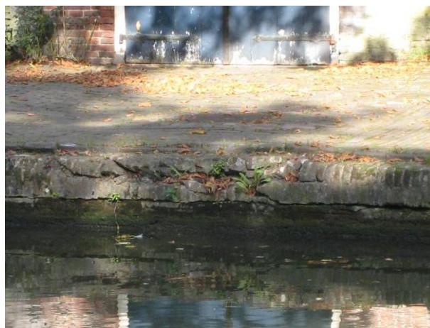
Foto 8 zwaar beschadigde walmuur
