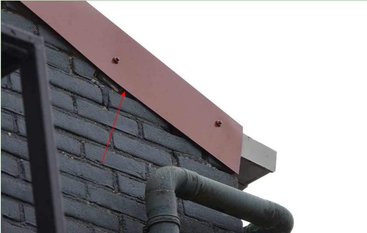
Gaten onder de dakbelijsting in het oostelijk deel van de bebouwing geven mogelijk toegang tot dieper gelegen holtes in de bebouwing die geschikt is voor verblijvende vleermuizen.
