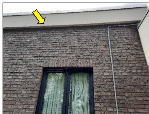
Figuur 12. Ruimte tussen dakbetimmering en gevel.
