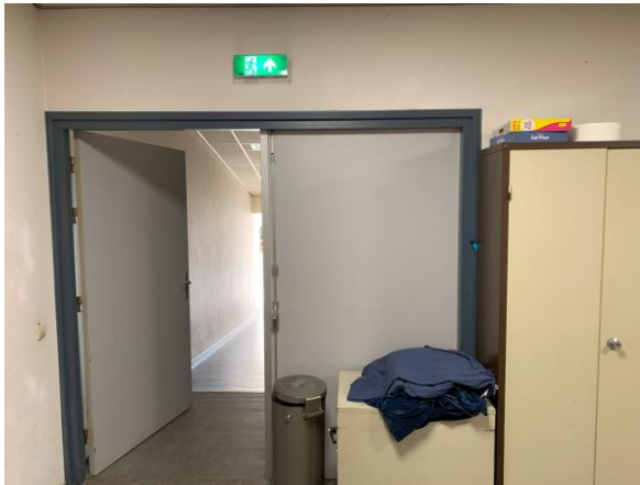
Foto 7: Dubbele vluchtdeur vanuit vergader-/kleedruimte richting hellingbaan en entree ruimte. Beide deurhelften van de deur zijn te openen. Boven de deur is vluchtrouteaanduiding aanwezig welke gehandhaafd en onderhouden moet worden. Het is niet toegestaan de vluchtdeur te blokkeren met inrichting/inventaris. Deze dient derhalve verwijderd te worden.
