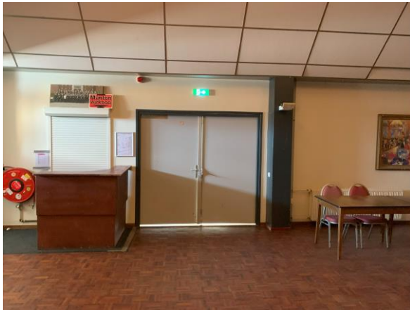
Foto 5: Dubbele vluchtdoor naar entree van de grote zaal. Beide deurelfen van de deur zijn in geval van een calamiteit te openen. Boven de deur is vluchtrouteaanduiding aanwezig welke gehandhaafd en onderhouden moet worden.
