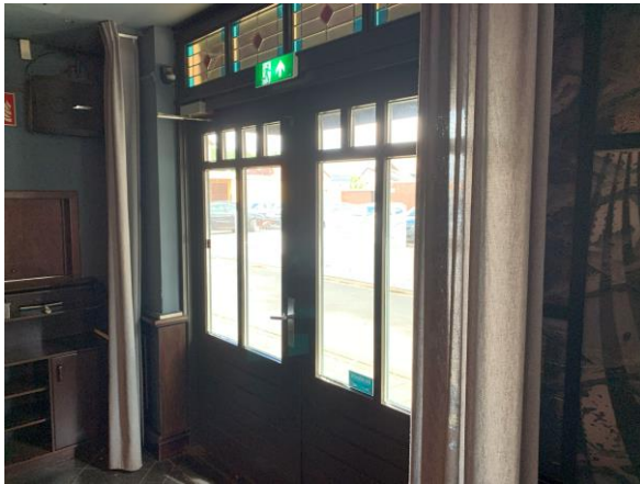
Foto 28: Dubbele deur van café naar aansluitend terrein. Dubbele deur heeft één draaiend deel en één vastgezet deel en draait met de vluchtrichting mee. De deuren zijn voorzien van vluchtrouteaanduiding welke gehandhaafd en onderhouden moet worden.
