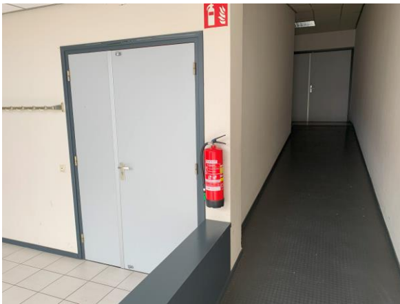
Foto 11: Vluchtroute vanuit podium en vergader-/kleedruimte voert via deze hellingbaan naar de entreeruimte en uitgang van het gebouw. Hellingbaan voldoet aan de voorwaarden voor bestaande bouw, derhalve akkoord. Deur naast hellingbaan betreft opslagruimte voor instrumenten van de harmonie. Deze was tijdens het bezoek op locatie niet toegankelijk.
