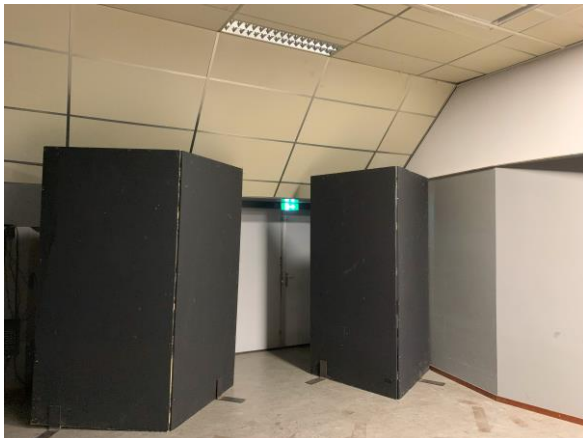
Foto 6: Dubbele vluchtdoor vanuit podium naar naastgelegen vergader-/kleedruimte. Beide deurelfen van de deur zijn te openen. Boven de deur is vluchtrouteaanduiding aanwezig welke gehandhaafd en onderhouden moet worden.
