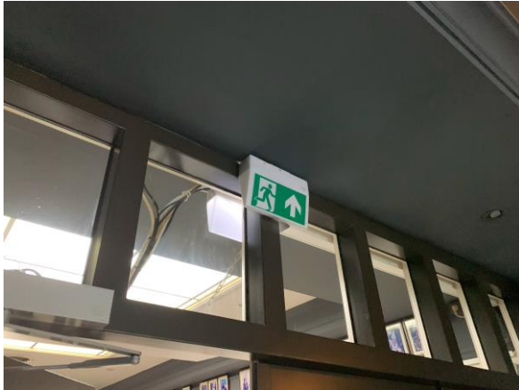
Foto 26: Dubbele deurconstructie aanwezig vanuit café naar gang. De deur bestaat uit één draaiend gedeelte en een vastgezet deel. Boven de deur is vluchtrouteaanduiding aanwezig welke gehandhaafd en onderhouden moet worden.
