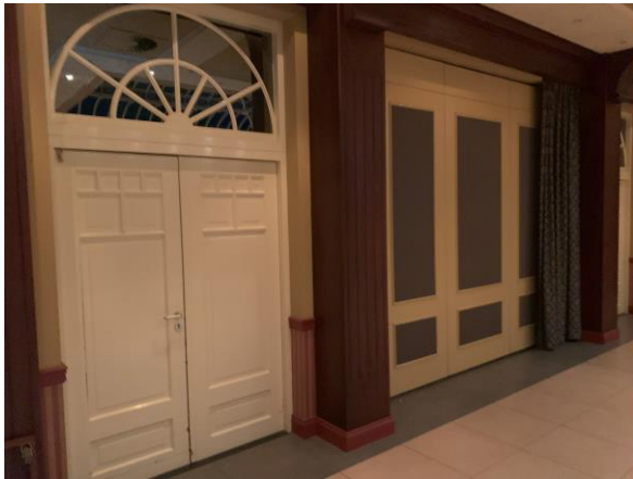
Foto 20: Dubbele deur vanuit kleine zaal naar café. Eén deurhelft is te openen in geval van een calamiteit en draait met de vluchtrichting mee. Andere deurhelft is vastgezet. Boven de deur is vluchtrouteaanduiding noodzakelijk. Deze handhaven en onderhouden.
