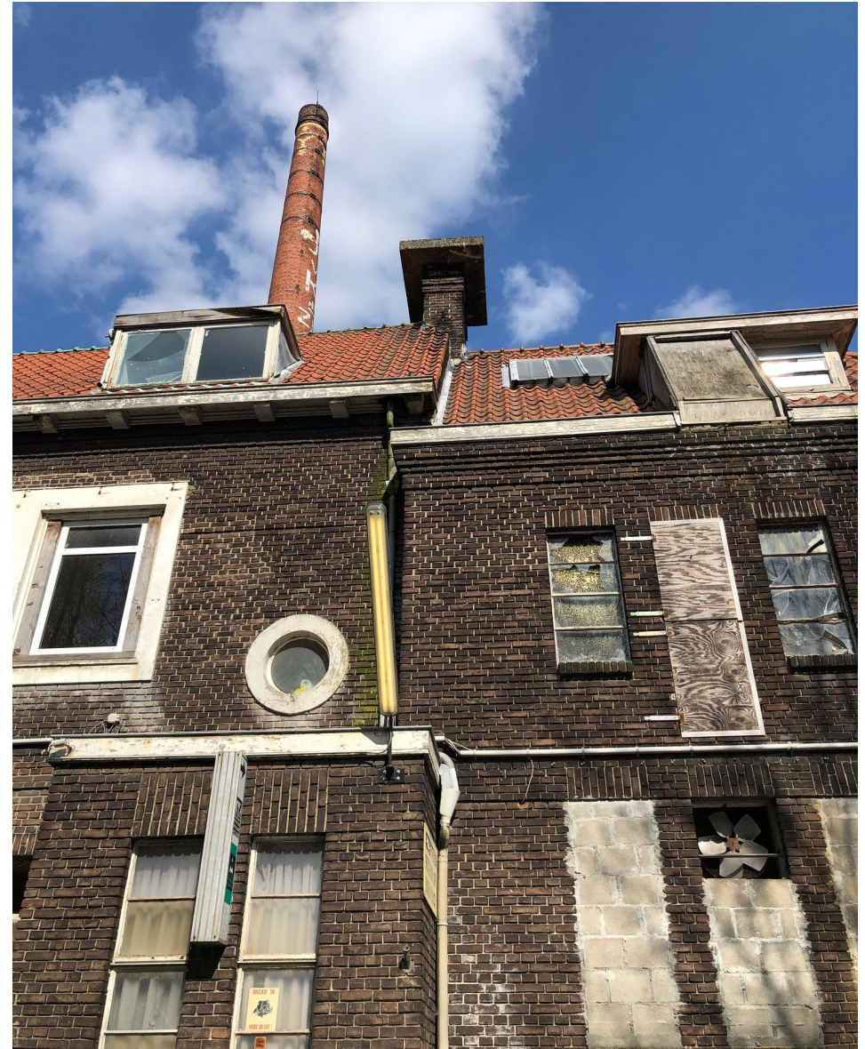
Afbeelding 3.2: Het hoofdgebouw van de voormalige fabriek in een vervallen staat.
