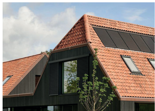
Figuur 8. Zonnepanelen terughoudend (indak) en in een eenduidig vlak toegepast.
