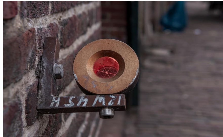
Meetprisma, monitoring werfmuur
