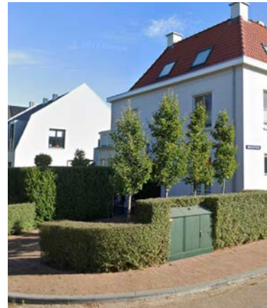
Technische ruimtes in haag.
