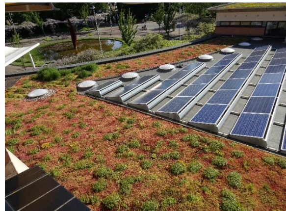
Figuur 13 Zonnepanelen gecombineerd met een sedum (groen) dak
